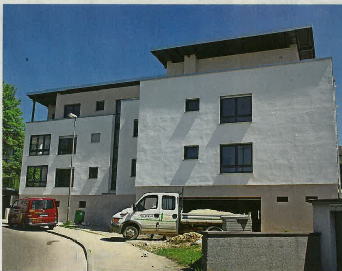
Die Bauarbeiten des Wohnhauses an der Virchowstraße neigen sich dem Ende zu.
