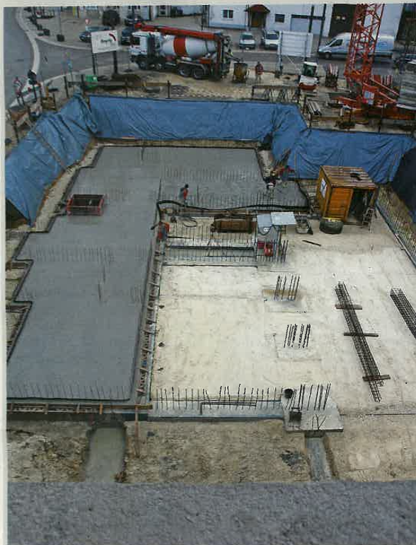
Die Bauarbeiten für den zweiten Bauabschnitt in Nattheims Mitte sind in vollem Gange.
